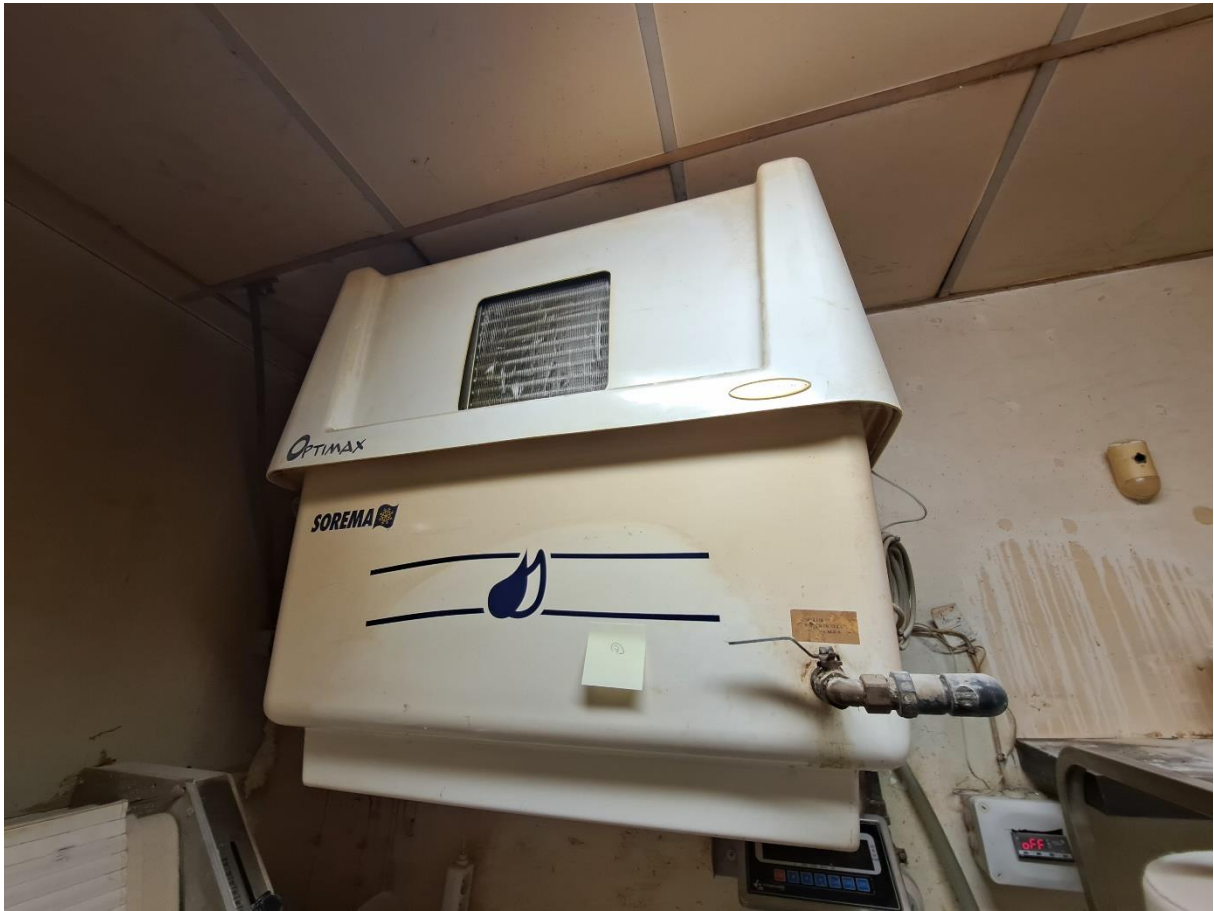
Lot n°7 : un refroidisseur de marque SOREMA
