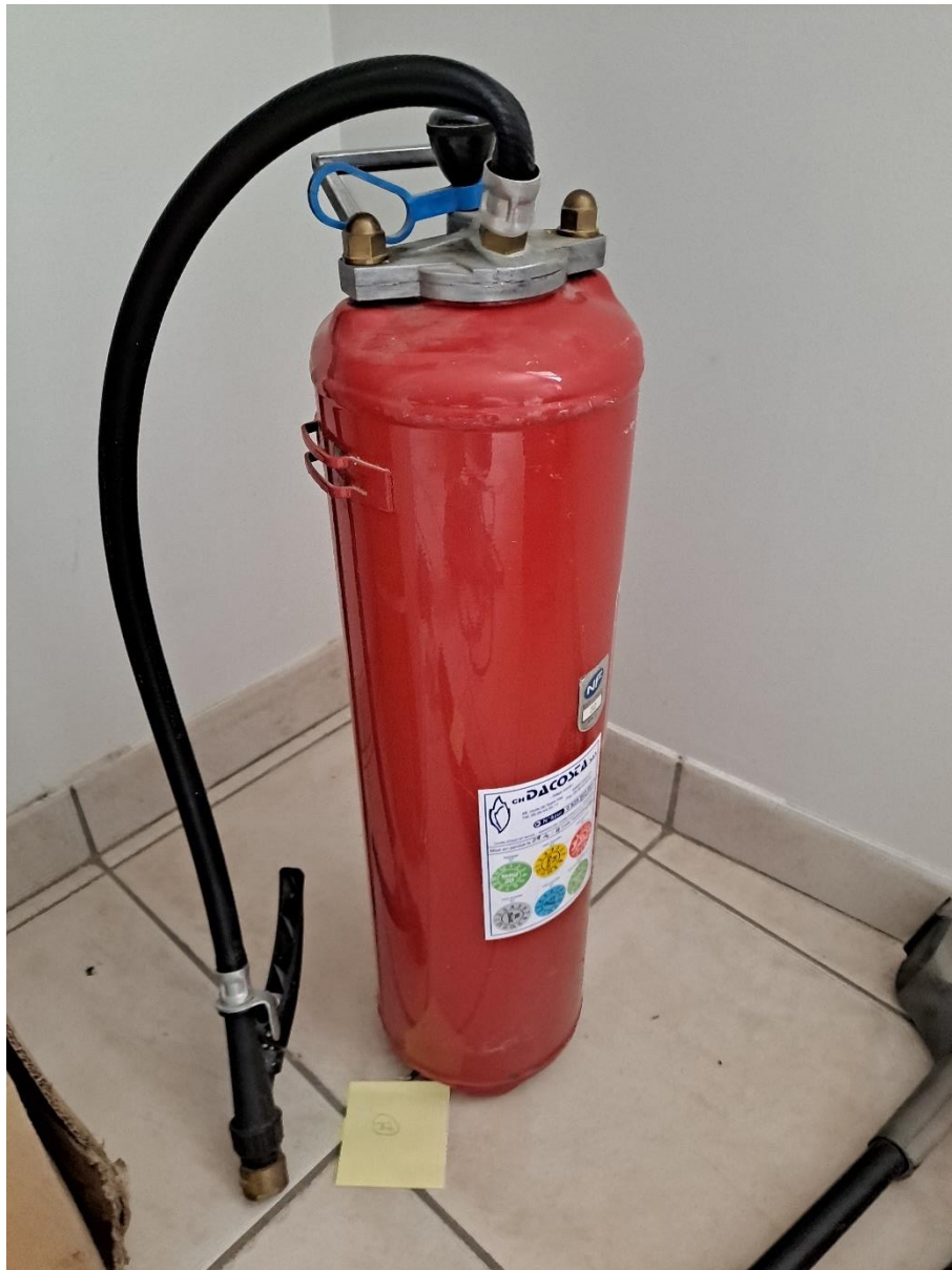
Lot n°38 : deux extincteurs
